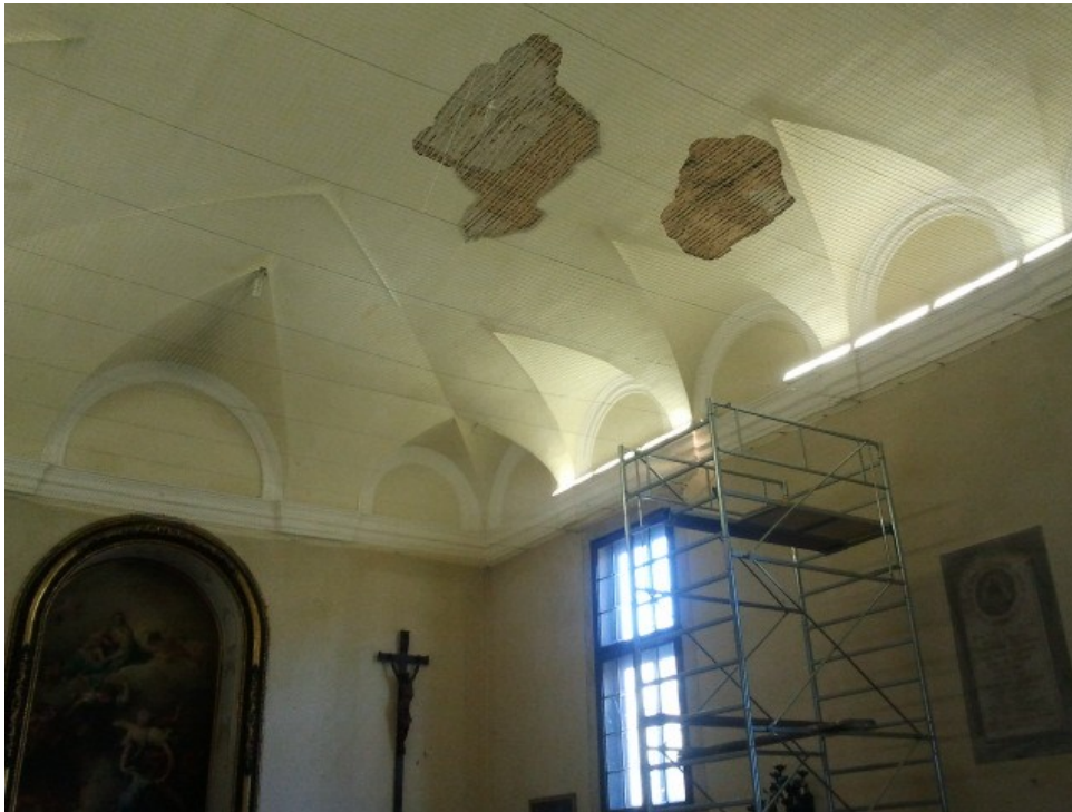
Die Schäden an der Kirchendecke — i danni al soffitto della chiesa.
